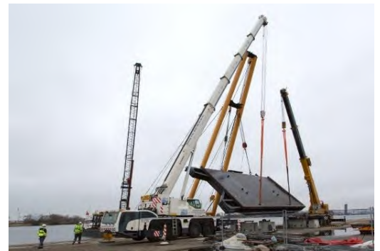
Porte d'èbe amont
